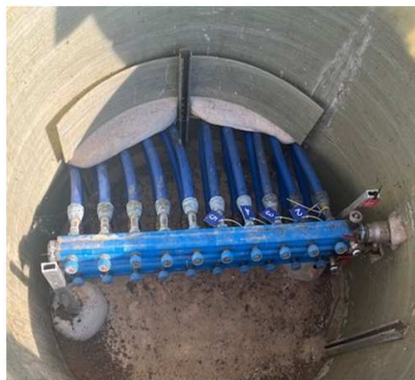
Contrôle des collecteurs de fluide caloporteur
