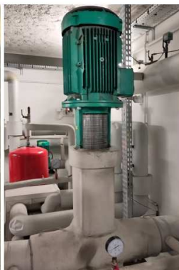
Contrôle des pompes et du circuit
